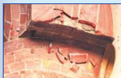
poškození rázovým namáháním
